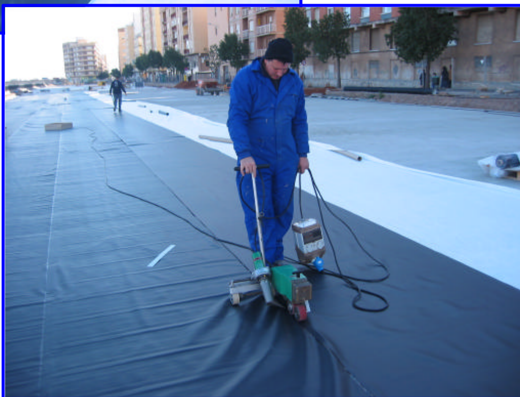
Soldador automático por “cuña caliente” en zona de solapes longitudinales entre láminas NOVANOL.
